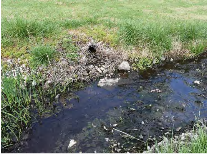
D2-I- Storm Drain
